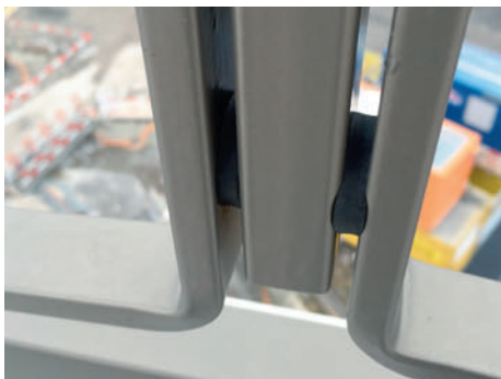
Bild 7: Die zwischenzeitlich durch Edelstahl ersetzten Gummi-Distanzscheiben als Verschraubung der Handlaufträger. Figure 7 : Les entretoises en caoutchouc depuis lors remplacées par des pièces en inox pour le boulonnage des supports de main courante.
